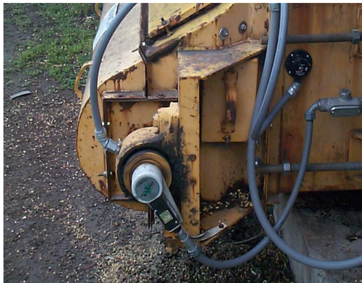
Whirligig instalado en un transportador cerrado, mostrado con un M800 speedswitch
